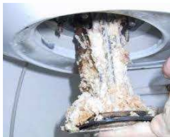
Résistance d'un chauffe-eau électrique entartré
