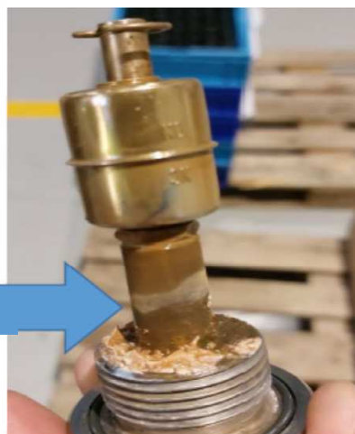
Détartrage en cours après seulement un mois (novembre 22)
