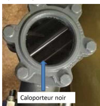
Contrôleur de circulation posé en juin 2020
