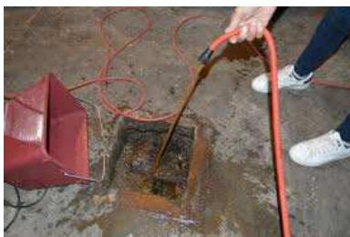
Eau d'un plancher chauffant sans désemboueur
